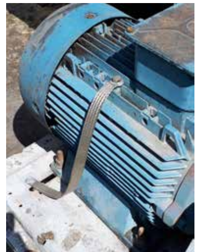
Liaison de masse pour gérer les courants perturbateurs d'origine Drive
